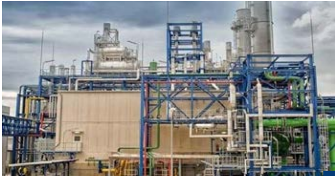
محطة الصبية لتوليد القوى الكهربائية
